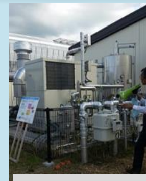
【トリジェネレーションシステム】
