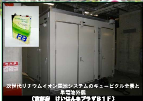
リチウムイオン蓄電池(30KWh) + PCS 【地下電気室】
