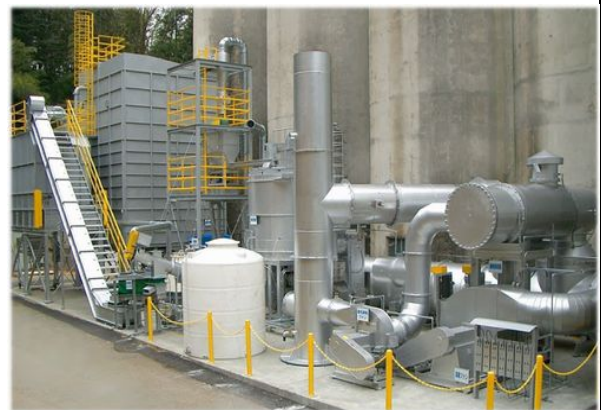
穀類炭化廃熱利用設備
