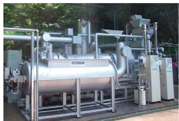
過熱水蒸気式ガス化・炭化装置(打越台)
